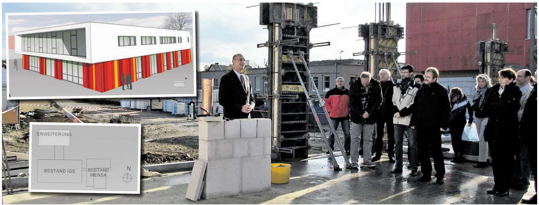
Landrat Franz Einhaus (Bildmitte) und Gäste während der Grundsteinlegung. Michael Schrader, Leiter des Kreis-Immobilienwirtschaftsbetriebs, sieht einer Fertigstellung zum Schuljahr 2013/2014 optimistisch entgegen. Die kleinen Fotos zeigen eine Skizze sowie die Lage des Erweiterungsbaus. Planung und Animation Immobilienwirtschaftsbetrieb
