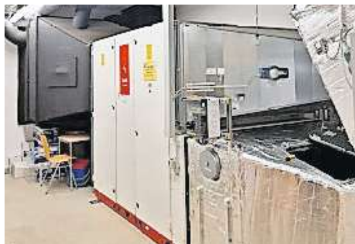
Die Lüftungsanlage der IGS Lengede nach dem Umbau.
